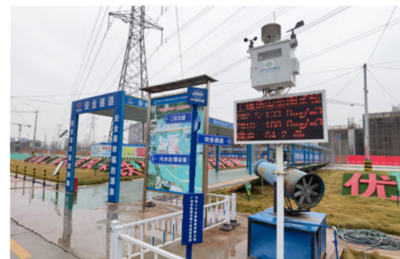
现场扬尘噪声监测装置
